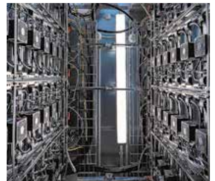
Innenleben eines Speichers: Modernste Technik.
